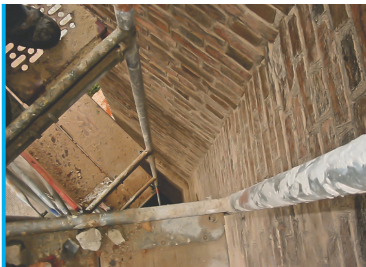
Fot. 7. Przykład pomostu roboczego niespełniającego wymagań bezpieczeństwa.
