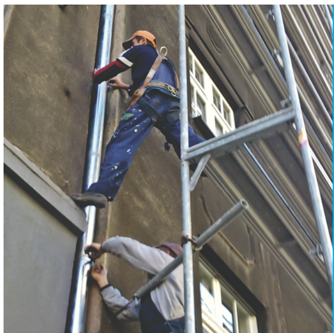
Fot. 6. Brak konsol poszerzających pomosty przy zbyt dużej odległości rusztowania od ściany (ponad 20 cm).
