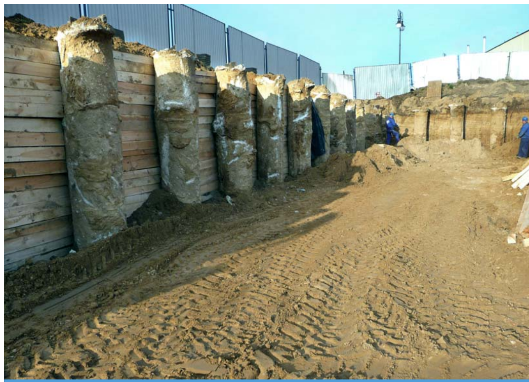
Fot. 21. Zabezpieczenie wykopu wykonane ścianką berlińską, gdzie elementem konstrukcyjnym są pale CFA. Ze względu na większą sztywność kolumn zabezpieczenie nie wymaga dodatkowego usztywnienia rozporami.
