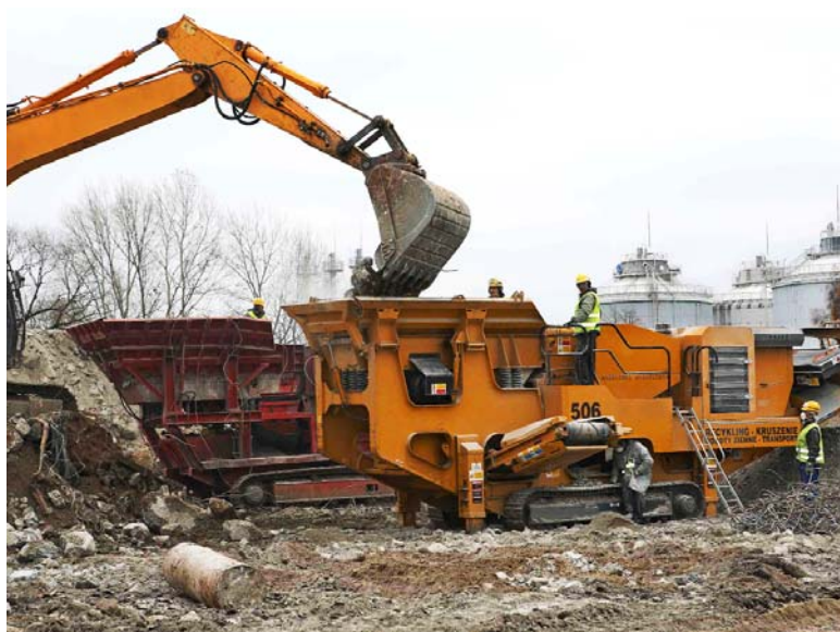
Fot. 4. Roboty przygotowawcze, polegające na usunięciu i utylizacji zbędnych elementów i budowli z terenu nowej inwestycji.
