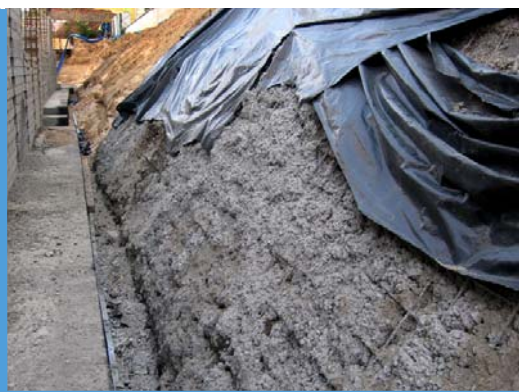
Fot. 17. Dodatkowym zabezpieczeniem przed rozmyciem skarpy i masy betonowej jest folia. Stosuje się ją do czasu utwardzenia się betonu.
