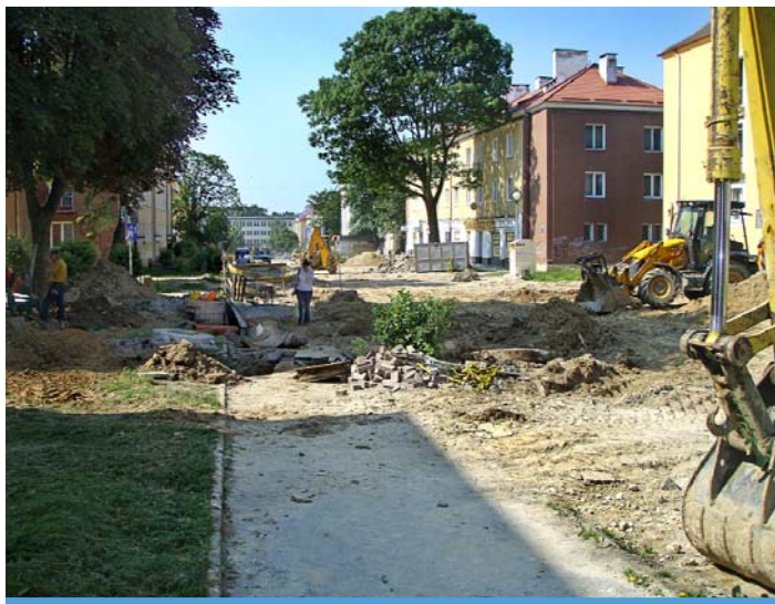
Fot. 31. Kierownictwo budowy nie zabezpieczyło terenu robót przed osobami niezatrudnionymi na budowie. Przechodnie wchodzą na teren budowy w miejscach nieprzygotowanych do ruchu pieszego, w bezpośrednim sąsiedztwie pracujących koparek. Sytuacja ta stwarza wiele zagrożeń m.in. takich jak: wpadnięcie do wykopu, upadek na nierównym podłożu lub dostanie się pod koła maszyn.
