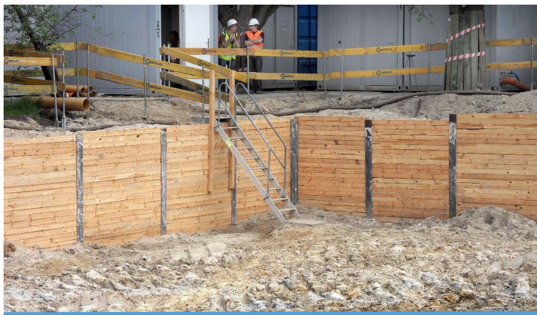
Fot. 5. Balustrady zabezpieczające przed upadkiem z wysokości.
