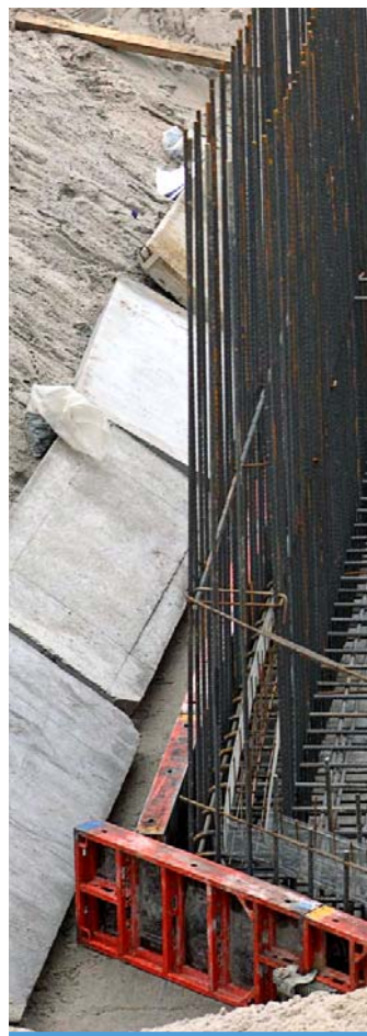
Fot. 15. Zabezpieczenie skarpy w poziomie posadowienia obiektu, płytami drogowymi typu „MON”. Płyty ułożono w celu ustabilizowania skarpy w miejscu, gdzie występuje największe ryzyko obsunięcia.
