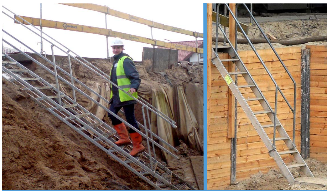
Fot. 6 i 7. Schody stanowiące drogę komunikacyjną do i z wykopu.
