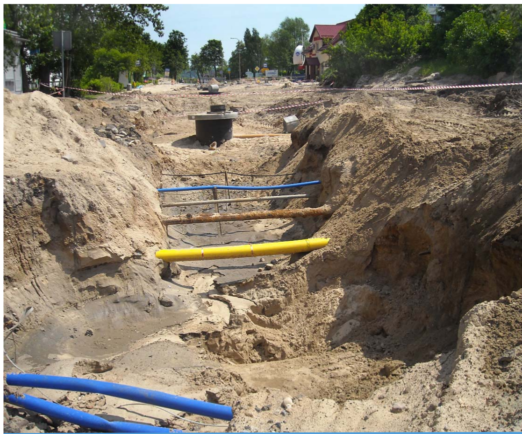
Fot. 3. Instalacje podziemne odkryte podczas prowadzenia robót ziemnych.
